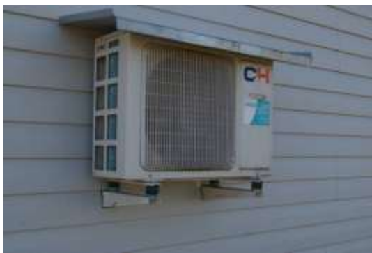
Būve (dzīvojamā ēka) ar kadastra apzīmējumu 6492 006 0316 001, siltumsūkņa ārējais bloks
