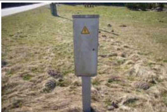
Zemes gabals ar kadastra apzīmējumu 6492 006 0316, elektrosadalne un uzskaite
